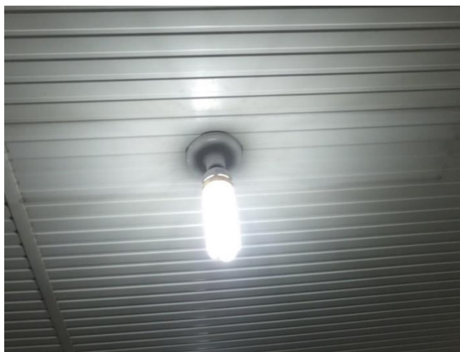
Figura 8. Foto de uma lâmpada CFL encontrada no edifício. Essas lâmpadas são mais econômicas que lâmpadas comuns, mas há opções de LED para substituí-las.
