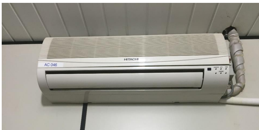
Figura 7. Foto de um dos equipamentos de Ar Condicionado Split encontrado na visita.
