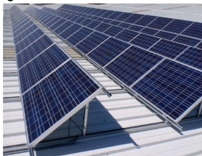
Figura 10. Exemplo de painéis solares instalados em telhados, tal como é indicado nessa medida.
